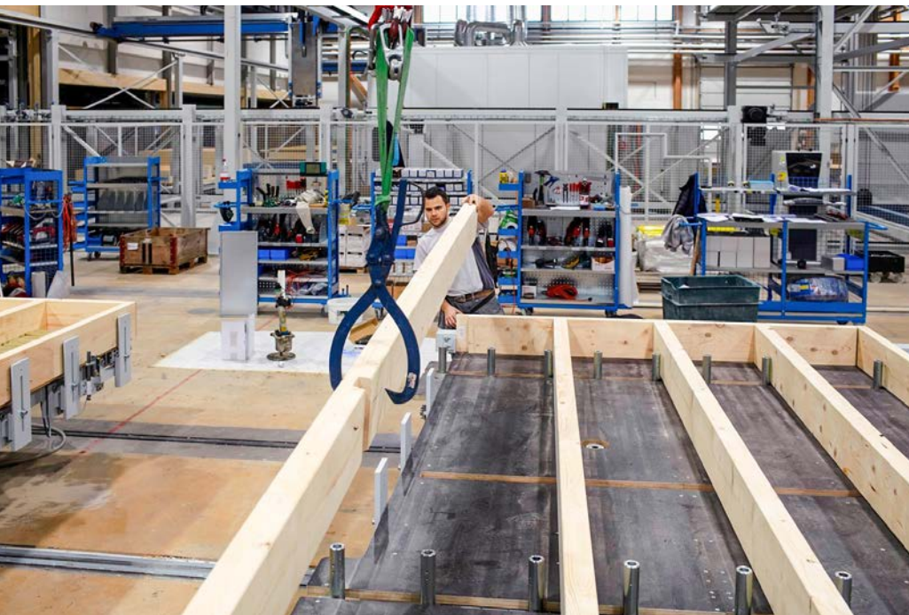
Das «Design to Production» ist in der Holzbranche bereits heute Realität. Bild: Holzbau Schweiz
